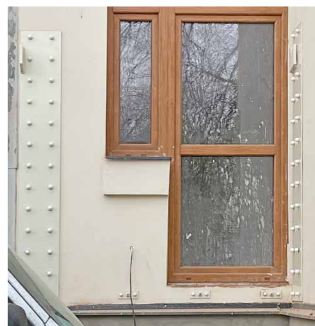
Naddimenzované kotvení u cihlového domu na Masné ulici v Ostravě
